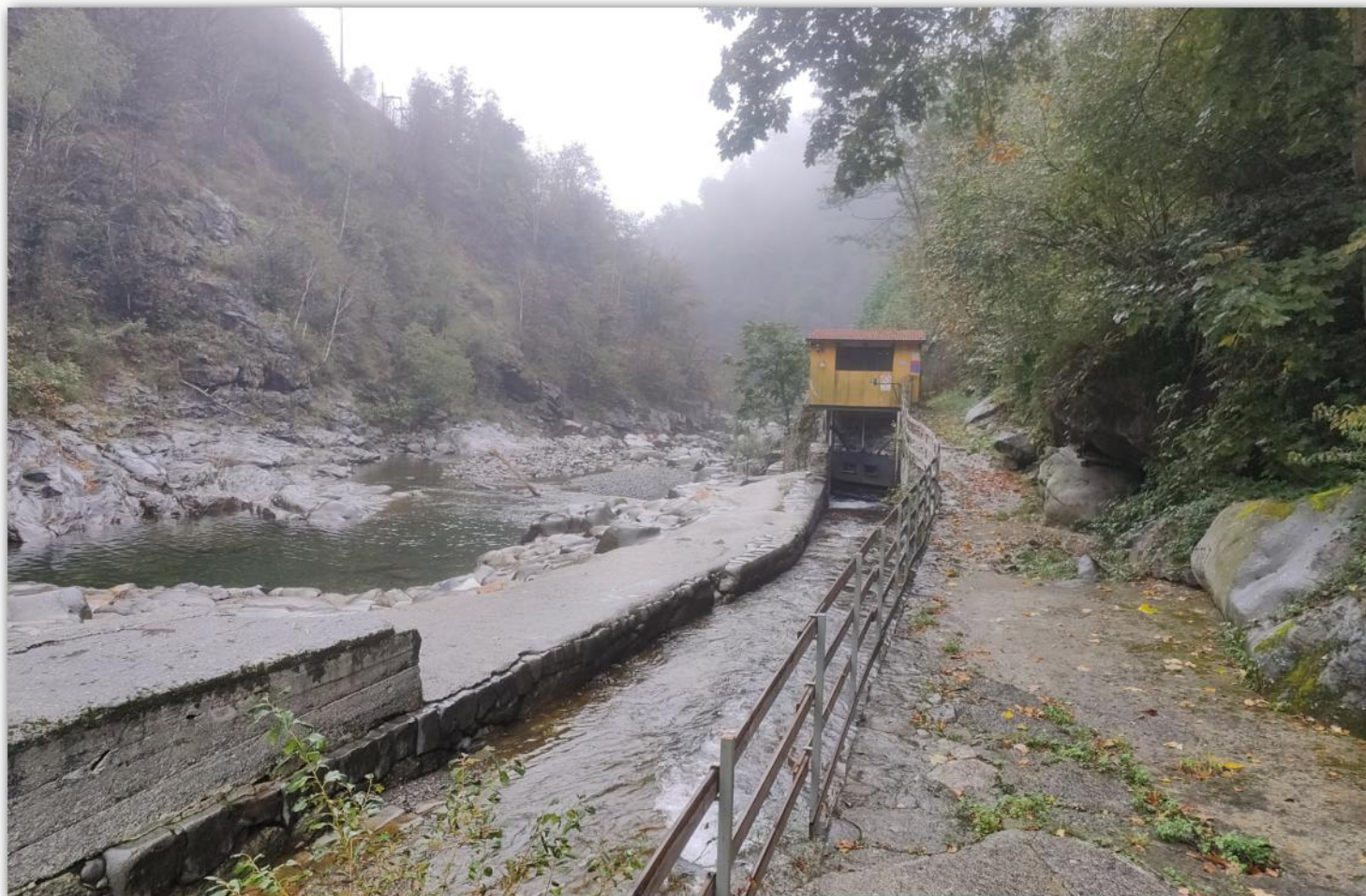
03 - Canale sghiaiatore e locale con paratoie di regolazione
