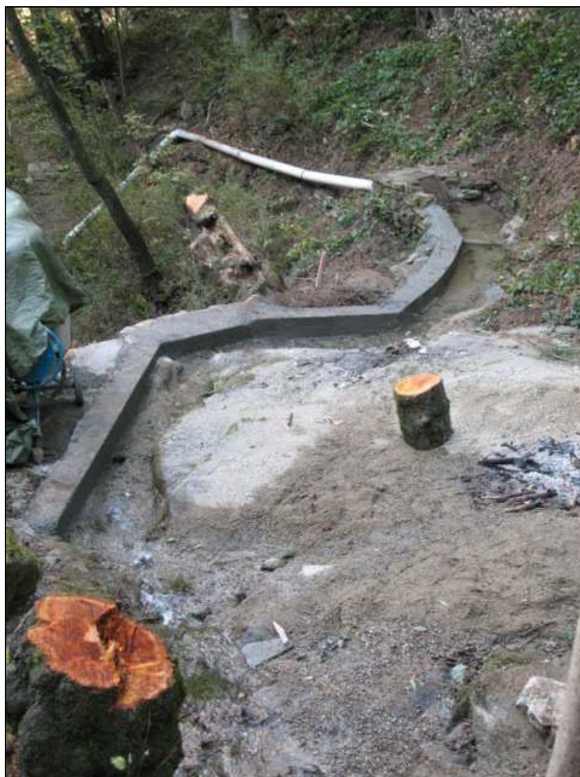
Fig. 8 - Dettaglio del canaletto inciso nella roccia che collega il rio Grande (in alto) al pozzetto in calcestruzzo di fig. 4
