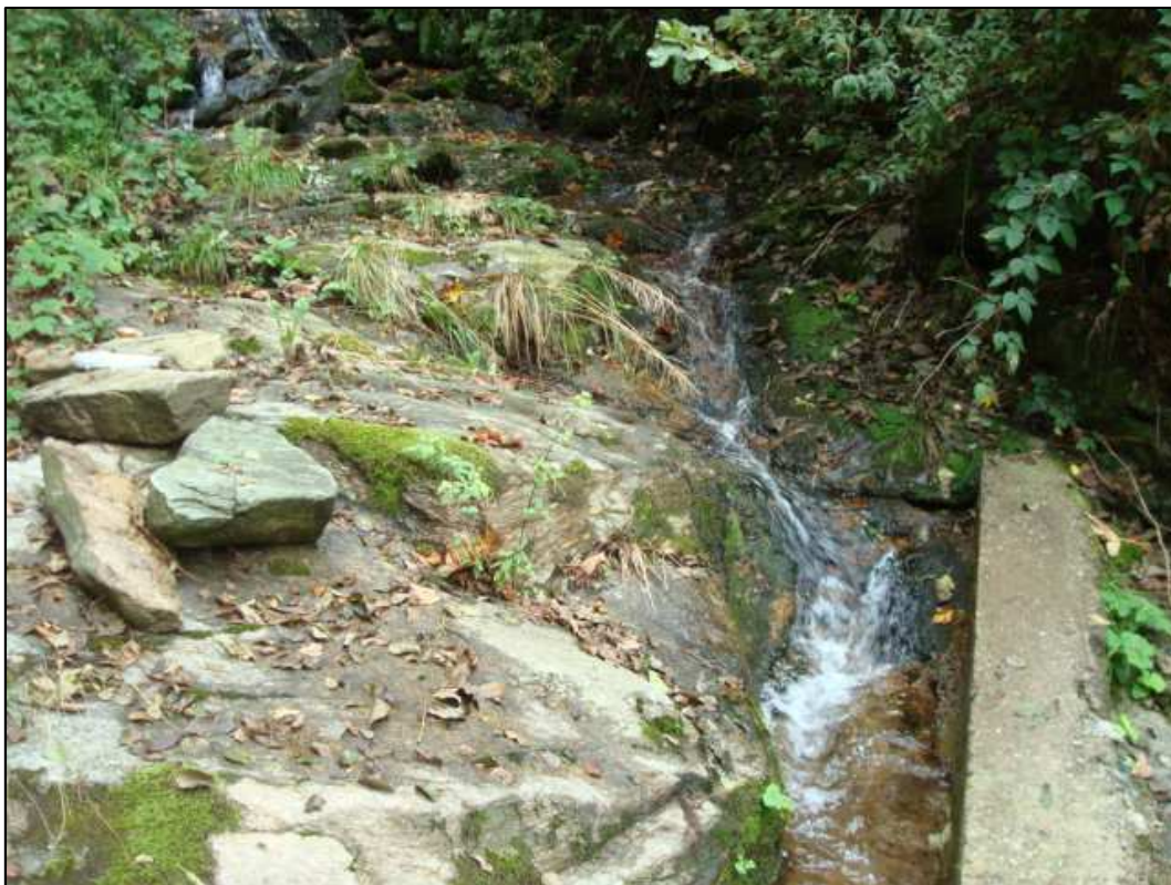
Fig. 10 - Immagine della situazione attuale del cordolo di derivazione nel punto in cui intercetta il flusso della corrente del Rio
