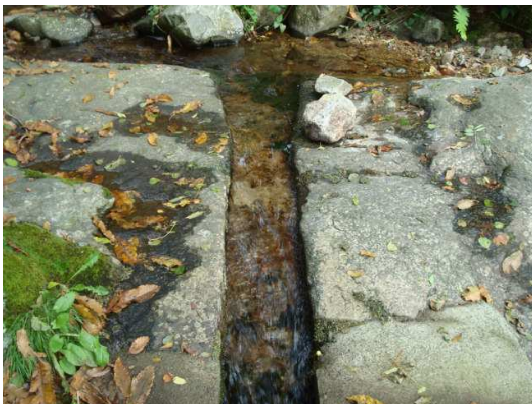
Fig. 6 - Dettaglio del canaletto inciso nella roccia che collega il rio Grande (in alto) al pozzetto in calcestruzzo di fig. 4
