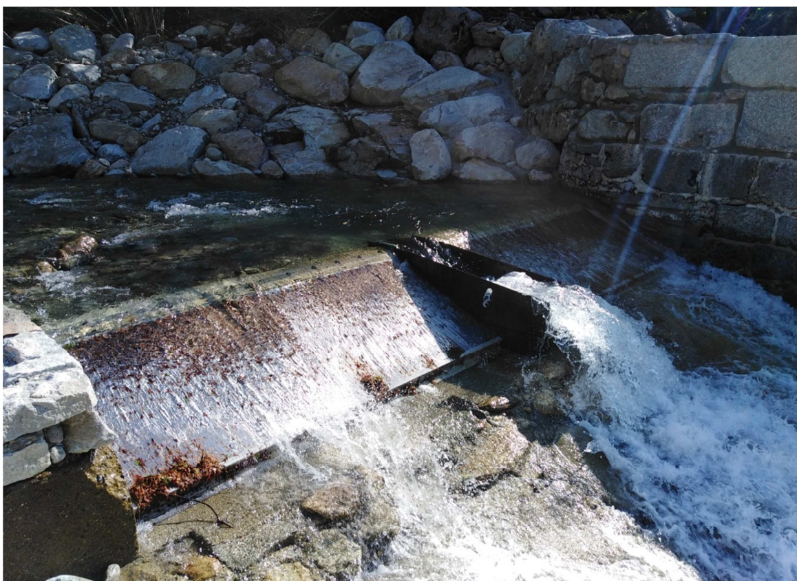
Fig. 1 – L'opera di presa sul torrente Oropa a seguito degli interventi di ripristino successivi agli eventi alluvionali dell'ottobre 2020. Al centro il dispositivo per il rilascio del DMV
