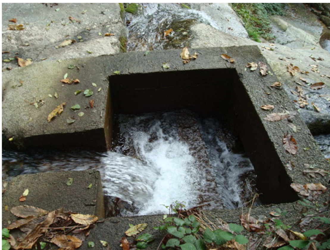
Fig. 2 - Opera di presa sul Rio Grande
