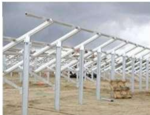
FIGURA 5 - STRUTTURE DI SOSTEGNO (TRACKER)
