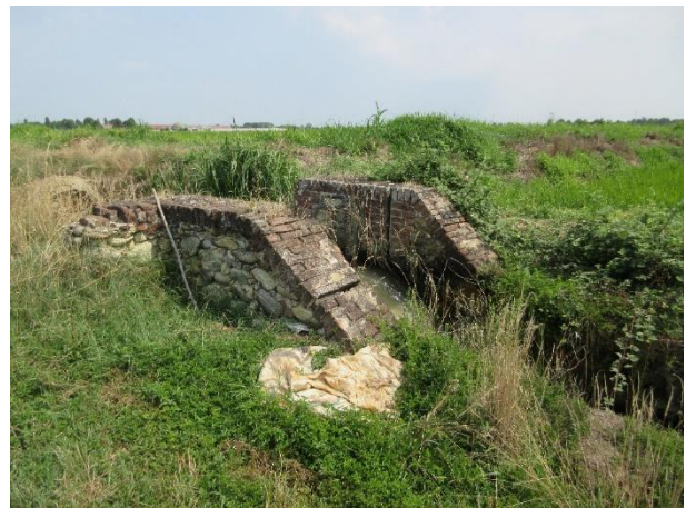
Canale irriguo, da sud ovest
