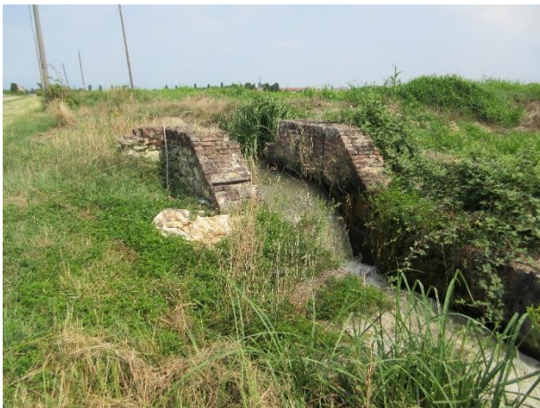
Canale irriguo, da sud ovest
