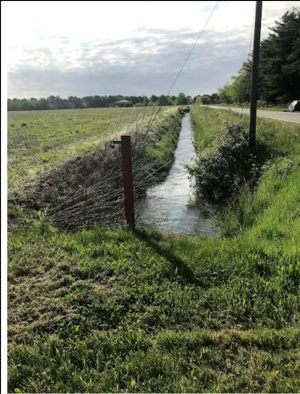
FIGURA 1 - FOTO FOSSO LUNGO LA STRADA PROVINCIALE
