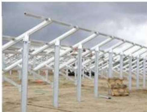
FIGURA 3 - STRUTTURE DI SOSTEGNO (TRACKER)
