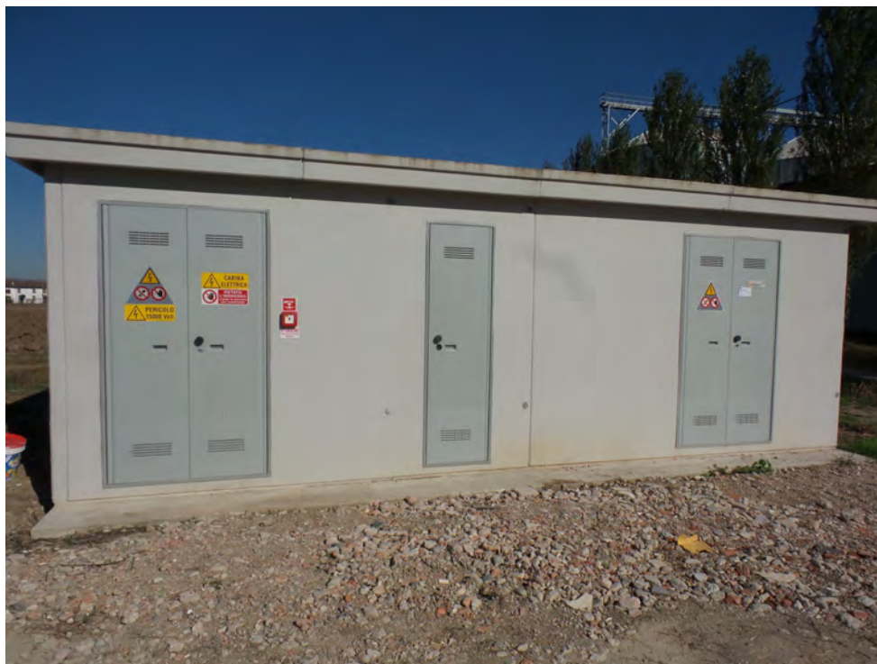
Tipica cabina in c.a.v.
