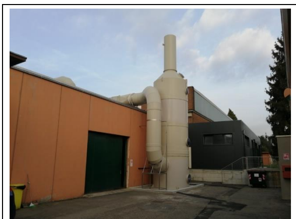
Vista posizione installazione interno cortile
