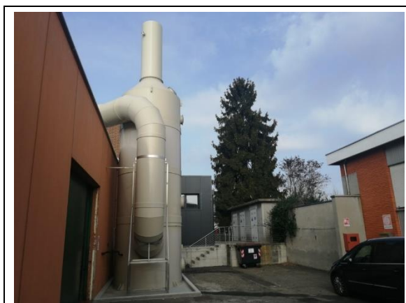
Vista posizione installazione interno cortile
