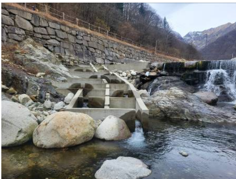
Figura foto 53: dettaglio scala di risalita ittiofauna (fotografia del 01/02/2024)
