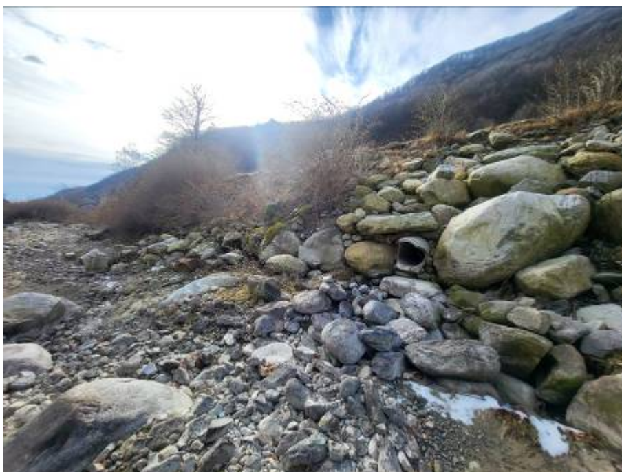
Figura foto 36: scarico centrale di produzione (fotografia del 01/02/2024)
