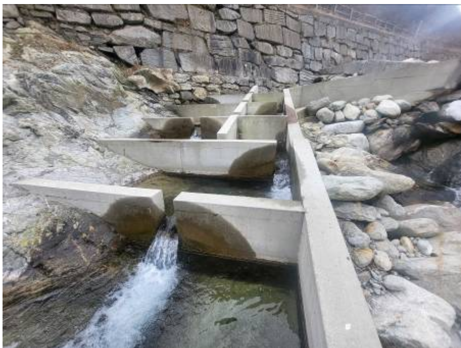
Figura foto 51: dettaglio scala di risalita ittiofauna (fotografia del 01/02/2024)
