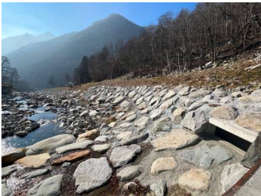
Figura foto 9: sponda destra del T. Chiobbia appena a valle della traversa di derivazione (fotografia del 21/02/2023); si noti lo sfioratore ad inizio canale di derivazione
