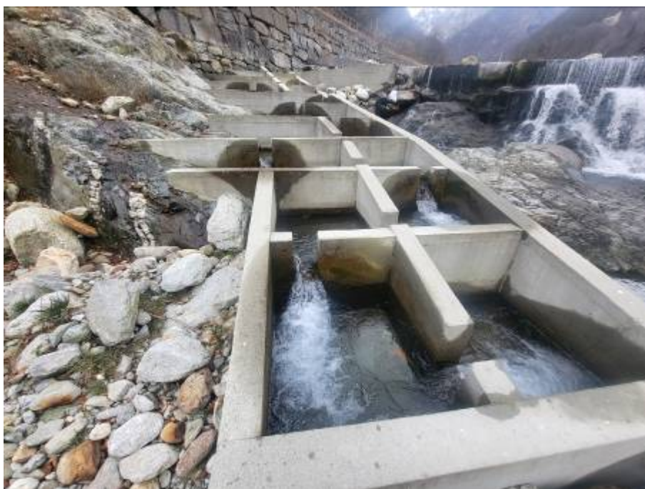
Figura foto 52: dettaglio scala di risalita ittiofauna (fotografia del 01/02/2024)
