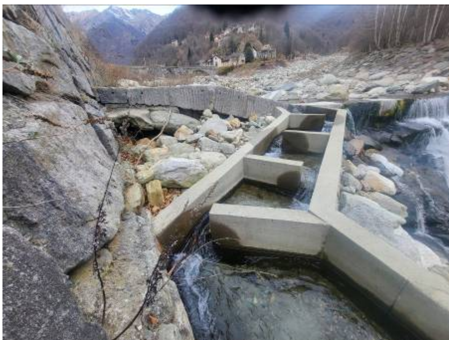
Figura foto 48: dettaglio scala di risalita ittiofauna (fotografia del 01/02/2024)
