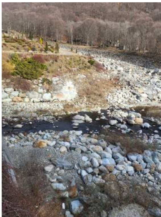
Figura foto 17: attraversamento del T. Cervo della condotta in subalveo a valle del Ponte Pinchiolo (fotografia del 01/02/2024)
