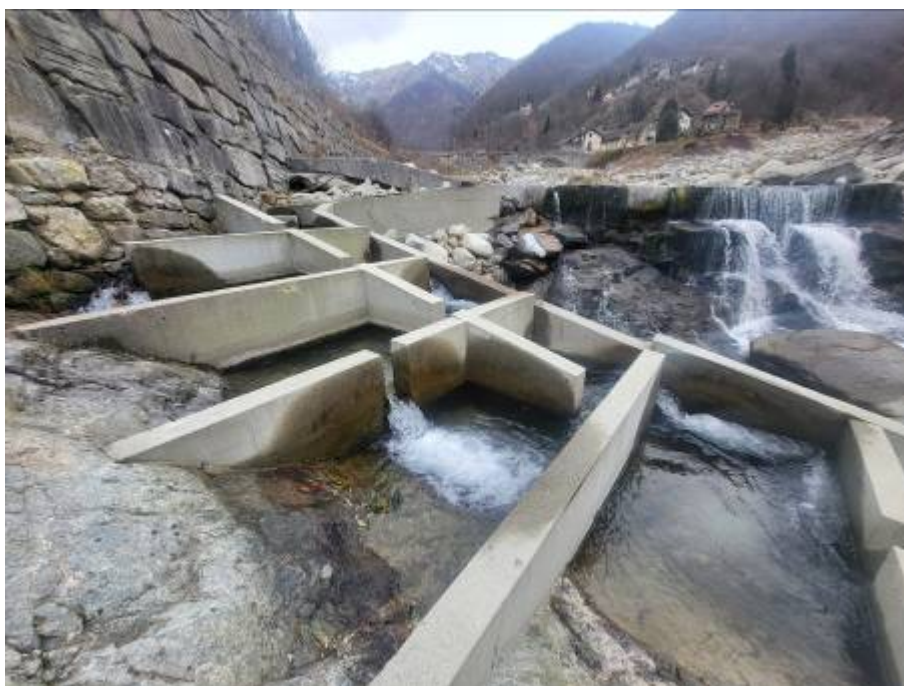
Figura foto 50: dettaglio scala di risalita ittiofauna (fotografia del 01/02/2024)
