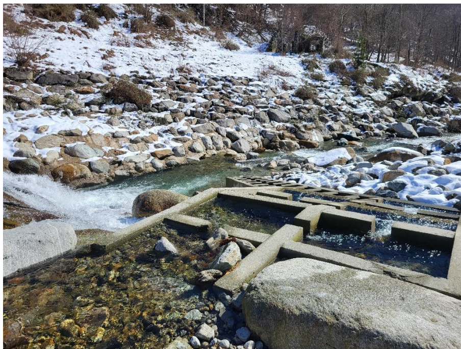
Figura 1: Vista luce di alimentazione su traversa
