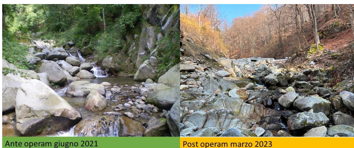
Figura 3.17: vista del punto di inserimento dell'opera di presa rispettivamente prima dei lavori e ad opere ultimate.
