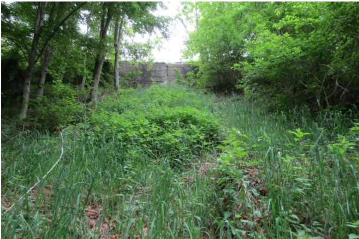
Particolare del tracciato della condotta idroelettrica interrata nel tratto subito a valle della SP115.I
