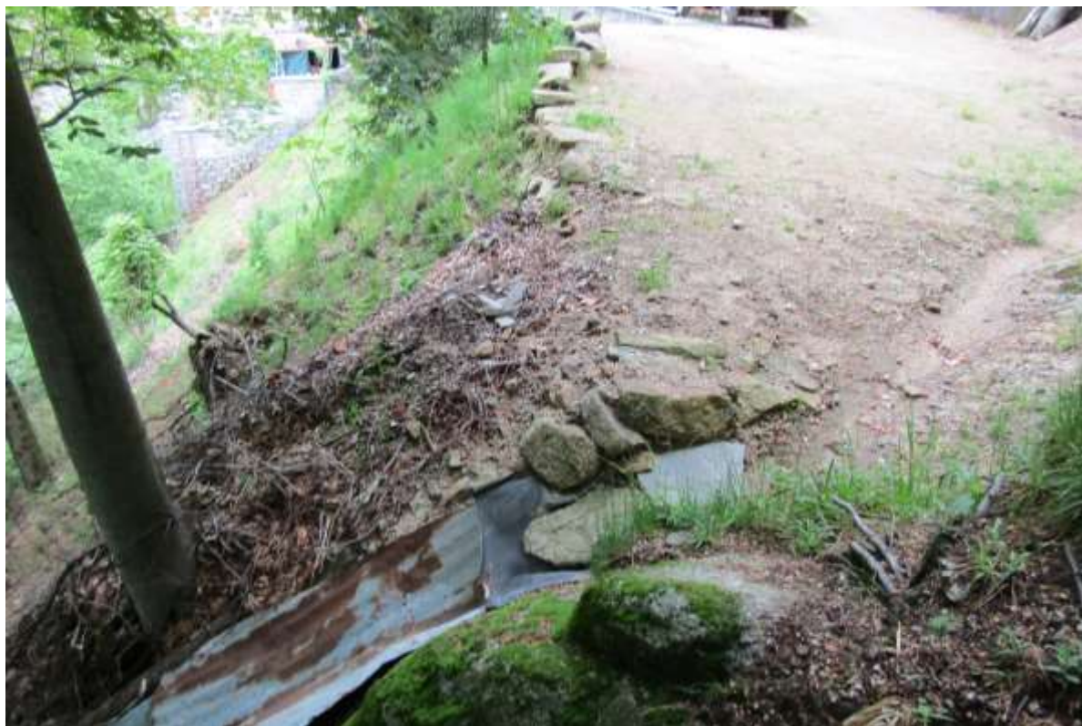
Particolare della canaletta in lamiera di ferro che scarica le acque dal tornante di quota 880 m.
