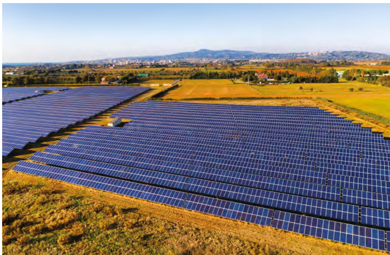
Figura 34 Esempio di impianto da 10MWpicco
