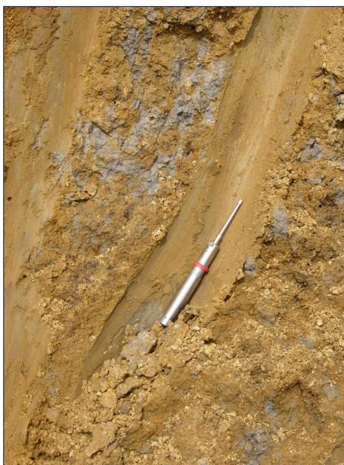
Figura 14 - Particolare della parete del pozzetto esplorativo con il Pocket penetrometer utilizzato per la misura di Cu .
