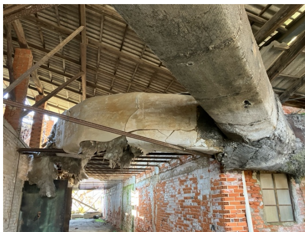
tubazione forno capannone 2.
