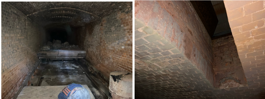
interno forno capannone 1 e camino forno capannone 1.
