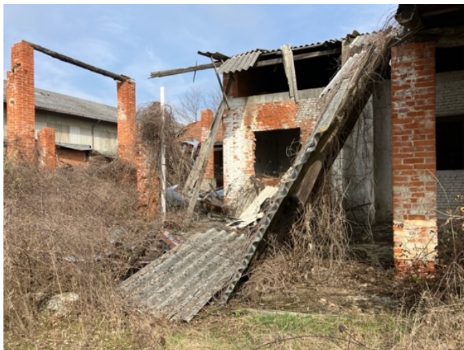
copertura crollata capannone 2
