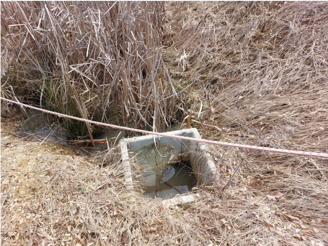
FOSSO FITODEPURAZIONE: Tratto terminale con pozzetto di scarico mediante condotta nel T. Guarabione )
