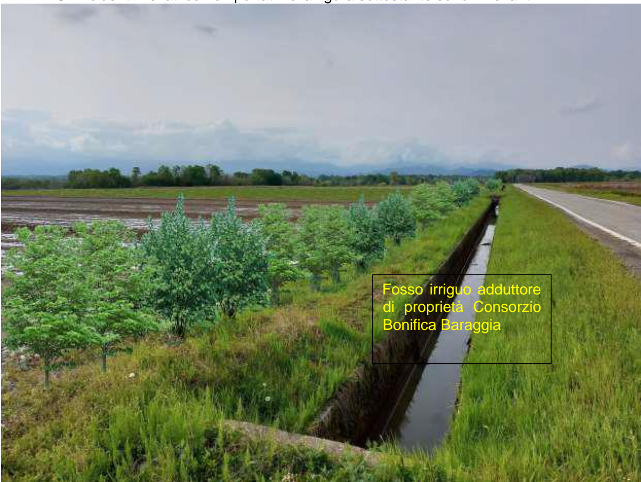
Figura 2 – Figura dell'area autorizzata, in cui è visibile canaletta in C.a. con funzione di fosso adduttore di proprietà del Consorzio di Bonifica della Baraggia. A bordo della scarpata sono stati piantumati un filare di arbusti che verranno replicati nella stessa posizione verso Sud nell'area di ampliamento.
